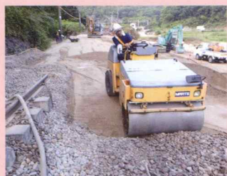
山陽本線(八本松~瀬野間) 盛土流出・道床流出
