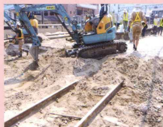
山陽本線(瀬野橋内) 土砂流入・線路冠水
