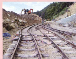
呉線(水尻橋内) 土砂流入
