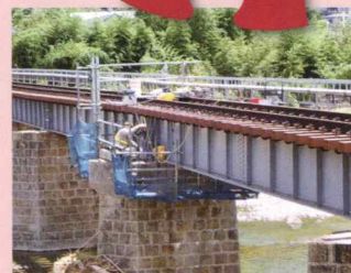
芸備線(上深川~中深川間) 橋脚傾斜
