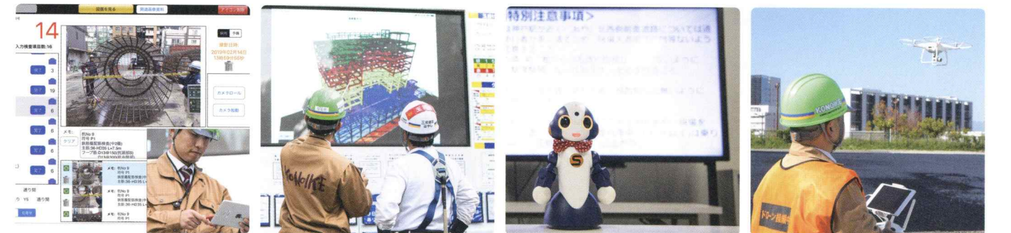
スマートデバイス: 机施工管理システム 大型サイネージ: 朝礼、打合せ プレゼンロボット: 新規入場者教育 ドローン: 写真撮影・測量
