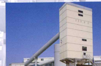
コンクリートプラント Concrete plant
