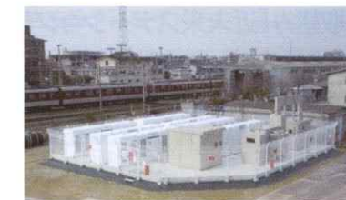
大規模蓄電池
