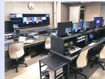
改修されたテレビスタジオ調整室
