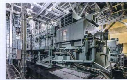
豊洲ベイサイドクロスタワー内に設置されたCGS
