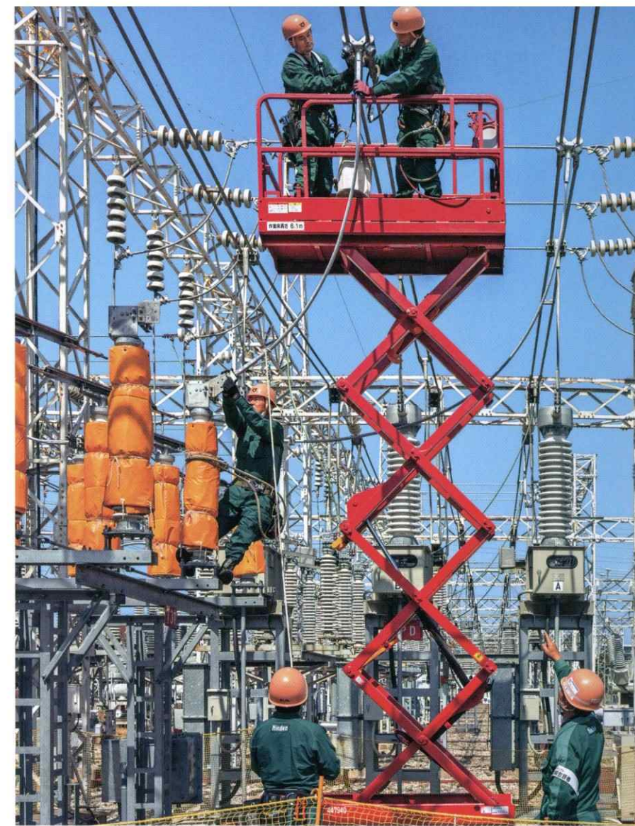
② 南大阪変電所77kV遮断器取替工事Ⅳ期に伴う除却工事のうち、電気工事(大阪)
