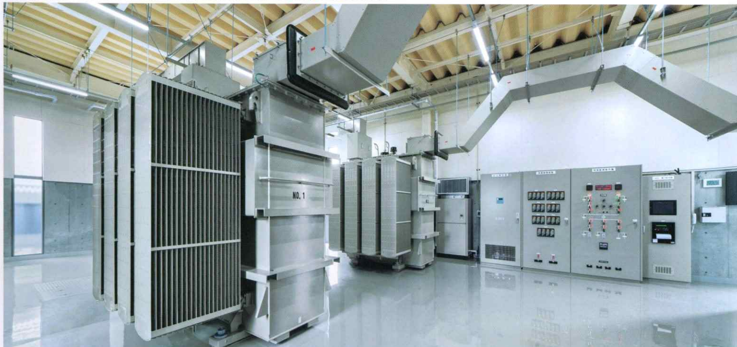
③SCREENホールディングス 彦根事業所 77kV特高受変電所 ■電気 ■計装 ■情報通信
