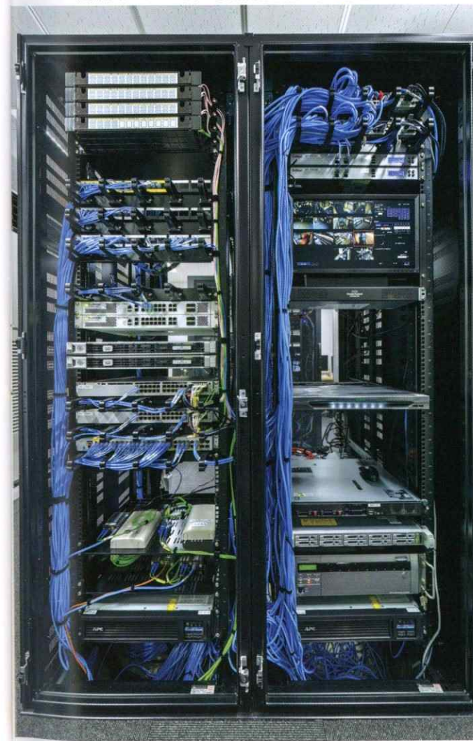
③ 大阪府済生会富田林病院 院内ネットワーク及び電話設備整備工事 ■情報通信
