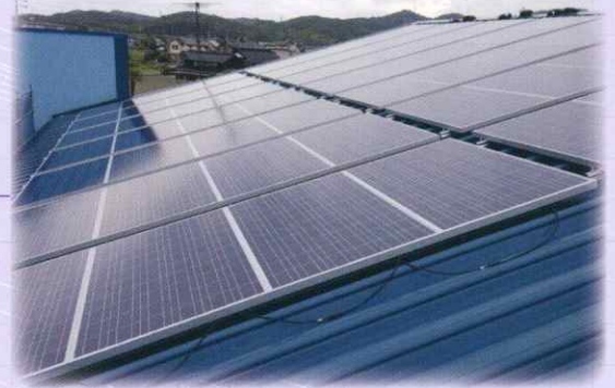
H ROOF パソコンPVシステム
