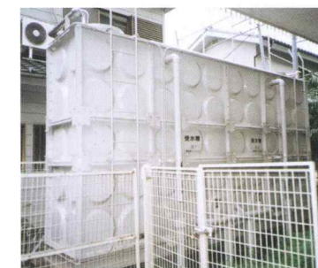
貯水槽清掃 容量10m 3 以上の貯水槽は1年に1回の定期清掃を実施するように、法律で規定されています。
