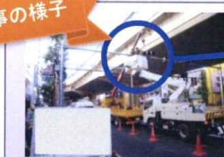
信号機取替工事 電球式の信号機をLED式の信号機等に取り替える工事です。
