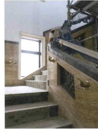
階段サイドの壁は沖繩産の石、手摺はバリアフリー基準に則った高さで真鍮手摺(転用)と復原手摺を追加。レリーフは創建時のデザインを鋳造
