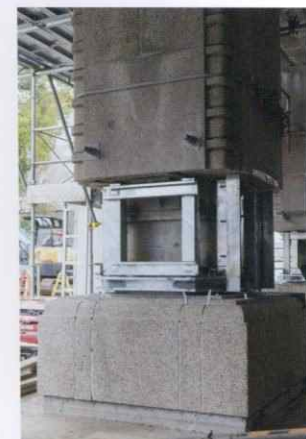
創建時の柱の免震改修。柱を一部くり抜き、鉄筋とコンクリートで補強する
