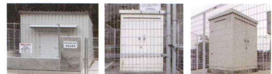
計量所 第1整圧所 第2整圧所
