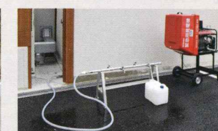
断水・停電時での水源確保（酒蔵通り駐車場採水所）
