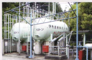
タンクによる特定製造所
