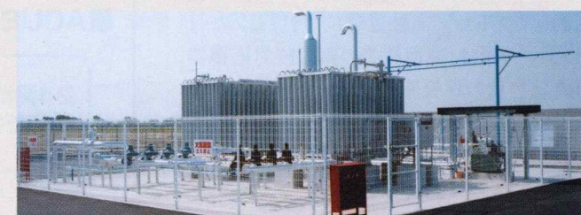
コミュニティーガス供給基地
