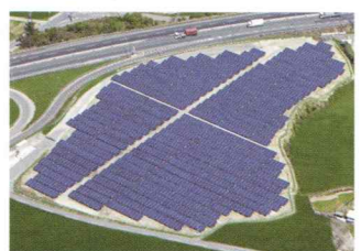
奈良小倉第一太陽光発電所 19,271㎡ / 1.6MW
