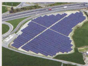
奈良小倉第一太陽光発電所 19,271㎡ / 1.6MW
