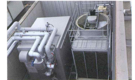
冷却用冷凍機
