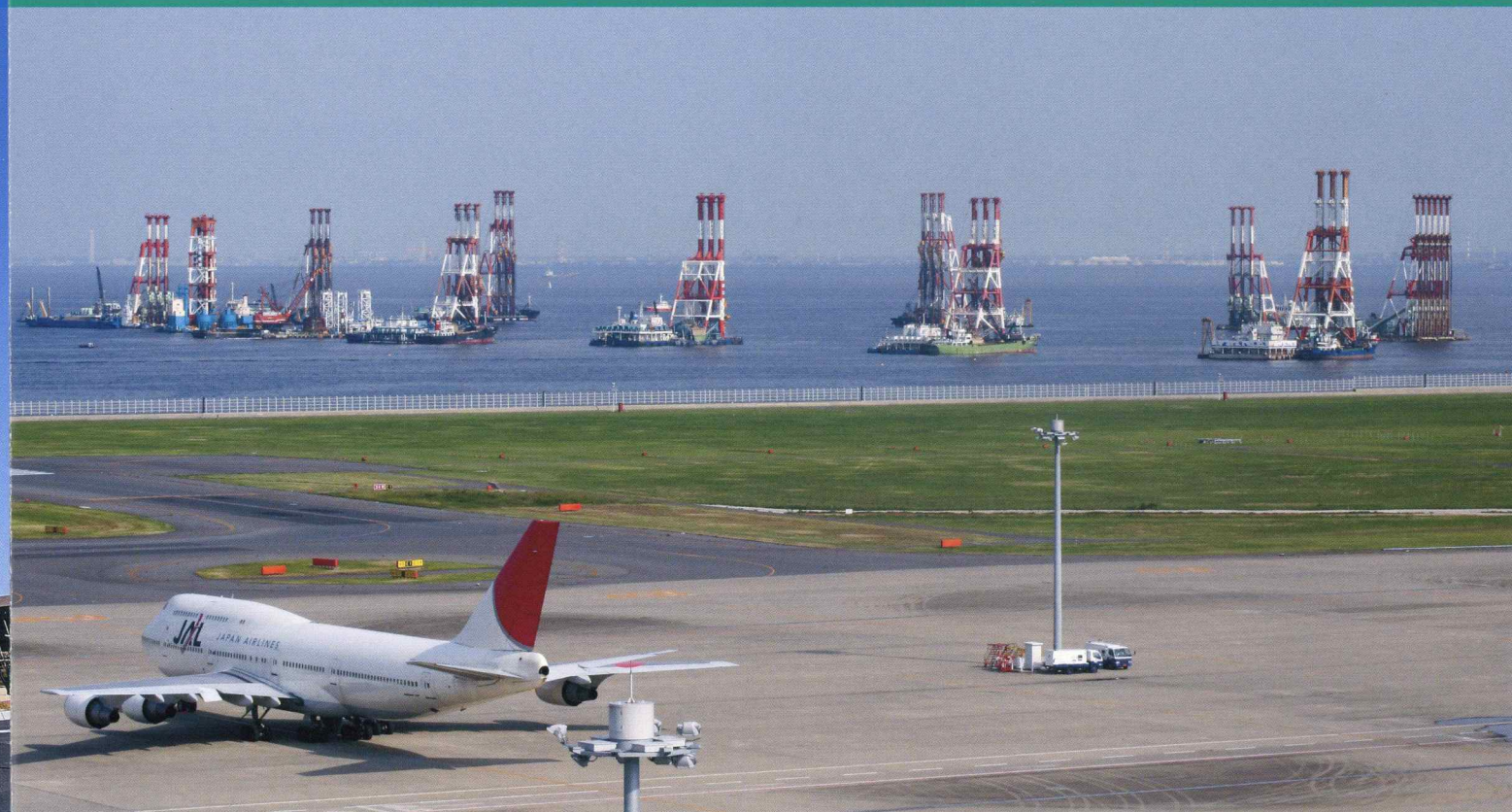
東京国際(羽田)空港拡張工事にて。右から4番目が弊社SCP船。
