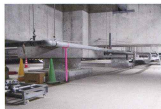
最先端の免震技術を採用
