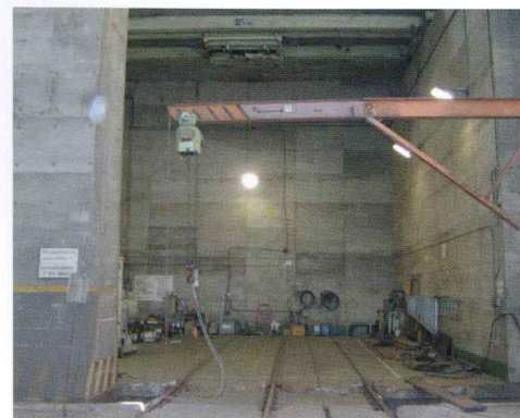
X線検査設備
