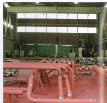
ボイラ工場 (管加工工場)
