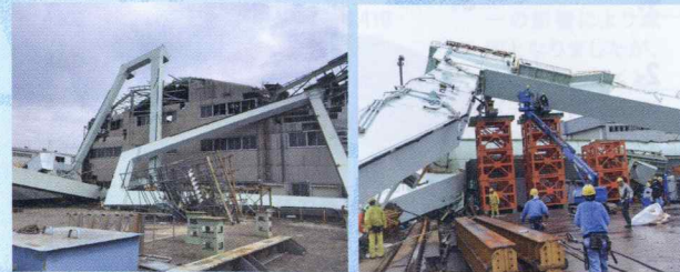
堺工場の倒壊したクレーン（左）と復旧の様子（右）
