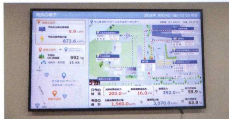
エネルギーマネジメントシステム管理室のモニター
