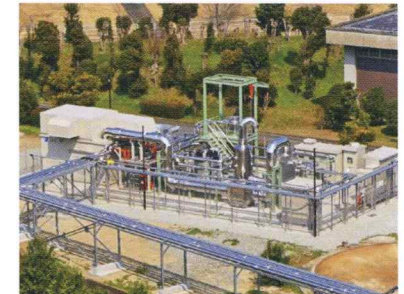
FIT 活用消化ガス発電
