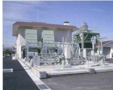
ポンプ場機械設備
