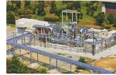
下水汚泥消化ガス発電設備
