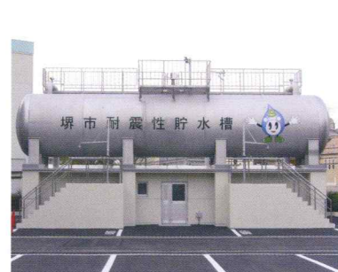
耐震性貯水槽
