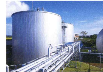
鋼板製消化タンク
