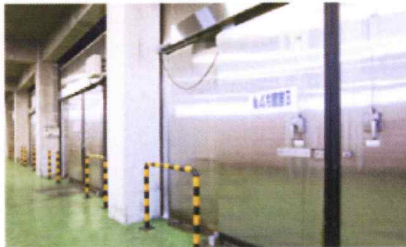
4室を設ける、1号倉庫の定温室は+2℃~+15℃まで設定可能。
