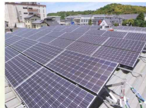
倉吉SS発電所
