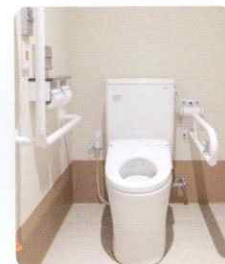
居室内トイレ
