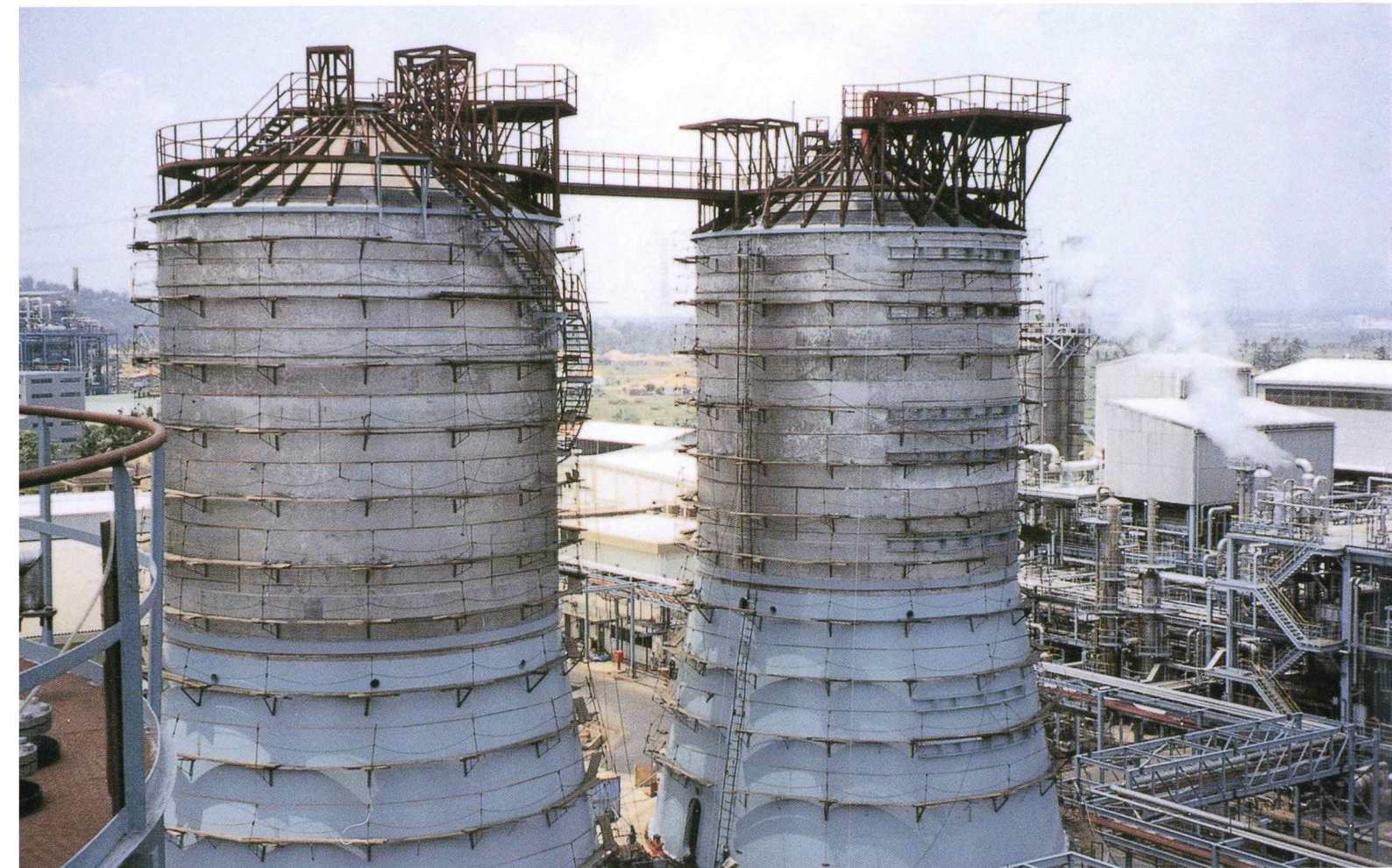
PTAプラント SUS304 サイロ 1500m 3 ×2基 PTA PLANT SUS304 SILO
