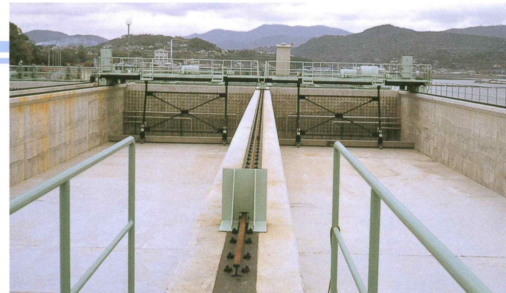
フライト式汚泥掻寄機 (10m 2 ×50m 1 ×4池) FLIGHT TYPE SLUDGE SCRAPER
