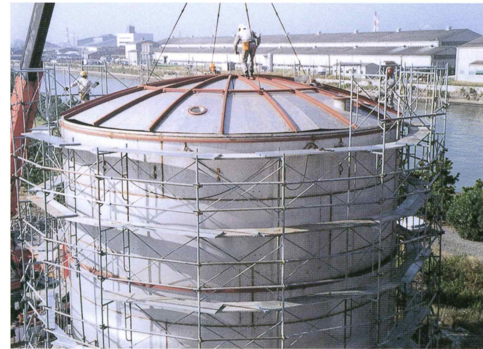
600KLドームルーフタンク DOOM ROOF TANK
