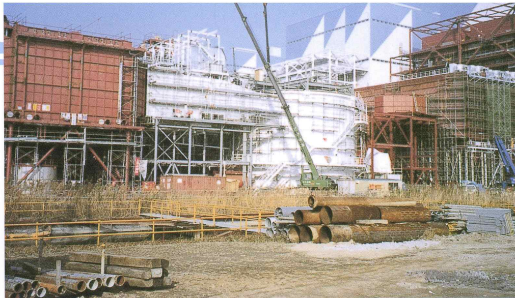
脱硫晶析槽及びダクト REACTOR & JOINT DUCT
