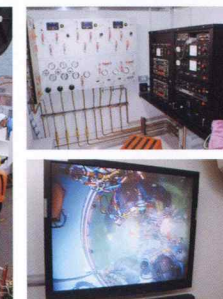
管制室(10fコンテナ)
