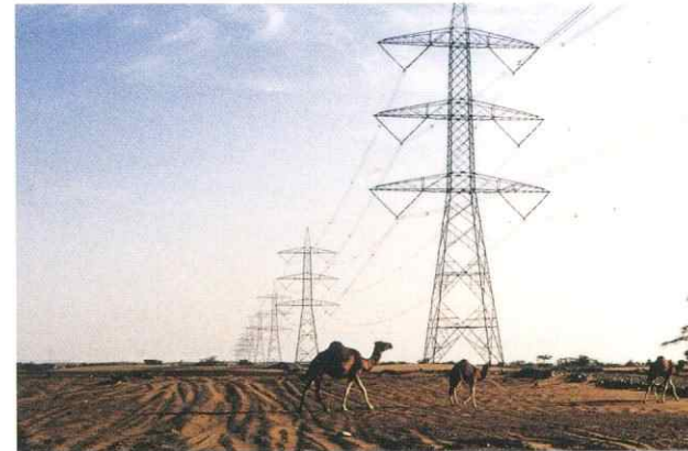
▲ラビーン〜ヤンブー線 (サウジアラビア) Rabigh-Yanbu transmission line towers (Saudi Arabia)
