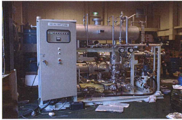
130kw電気ボイラー (保温施工前)
