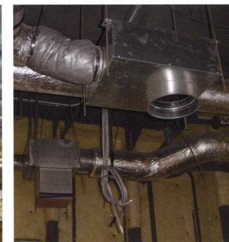
空気調和装置 (Air-Conditioner) 空調用吹出しボックス及びダクト Air Conditioning Cabin Unit & Duct
