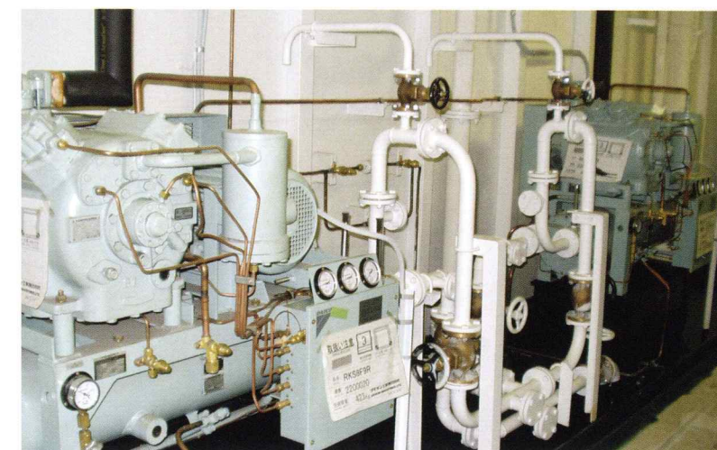
船用冷凍機 Refrigeration Unit
