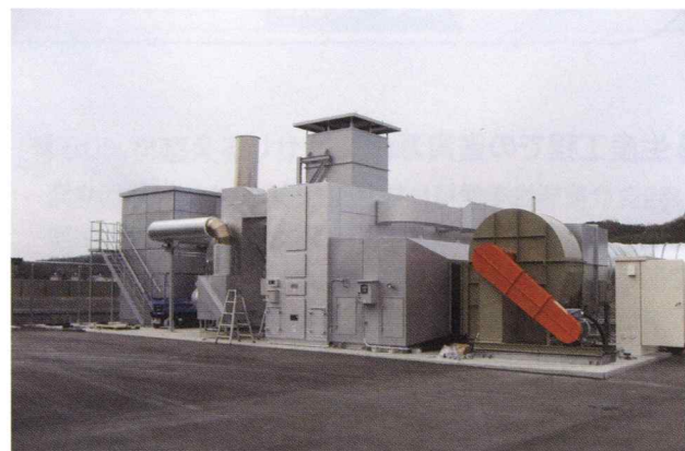
VOC廃ガス処理装置
