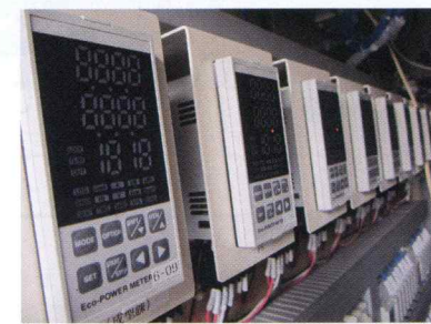
〈デマンド監視装置〉 電気使用状況をリアルタイムでモニタリングすることで電気使用のムリ・ムダを発見でき、効率的な省エネを実現。
