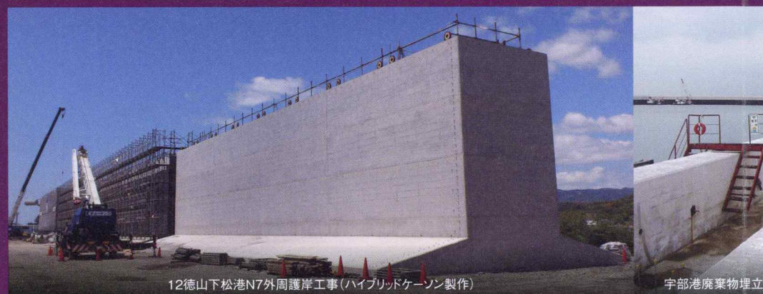
12徳山下松港N7外周護岸工事(ハイブリッドケーソン製作) 宇部港廃棄物埋立
