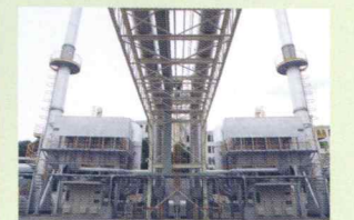
VOC処理装置 (上海工場)
