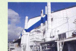
給排気装置 (滋賀工場)
