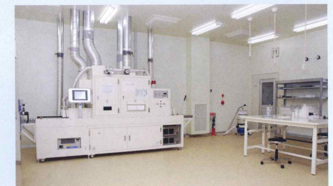
クリーン塗装室の紫外線照射器
