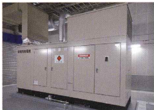
非常用発電機
