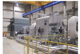
蒸気タービン・発電機
