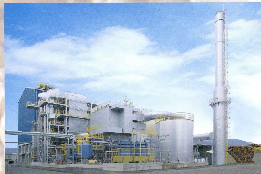
バイオマス発電(本社工場)
