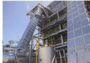
燃料供給コンベヤ
