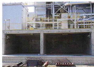
主灰ヤード・ダストヤード
