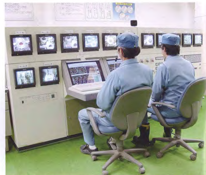
TNTプラント (制御盤) TNT Plant (Control Panel)
