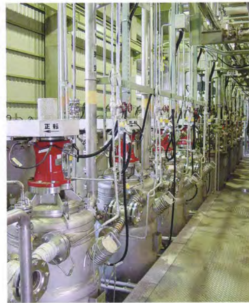
TNTプラント (反応槽) TNT Plant (Reaction Tank)
