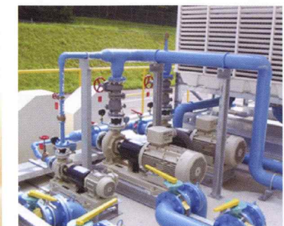
冷水設備(冷却塔・ポンプ)
