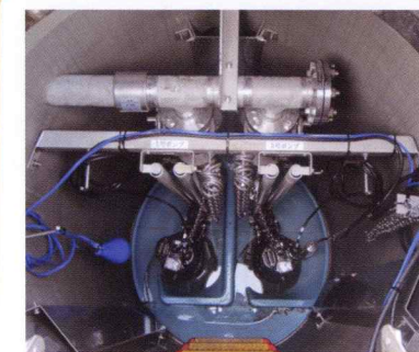
ポンプ設備(マンホールポンプ)
