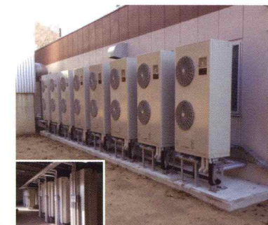
給湯設備(業務用エコキュート)
