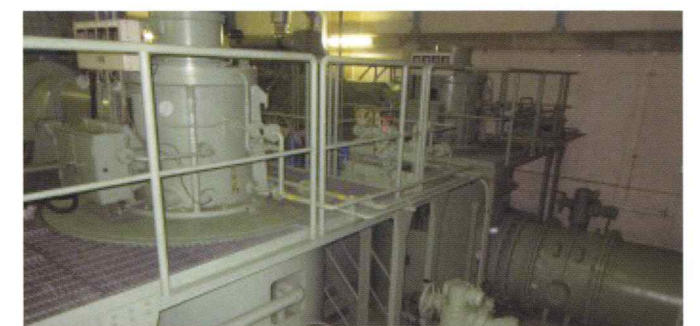
排水ポンプ設備
