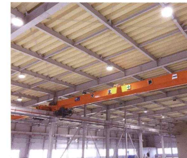
天井クレーン設備(ホイスト)
