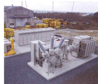
特別高圧受変電設備
