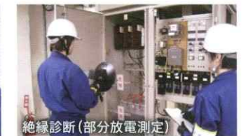
絶縁診断(部分放電測定)
