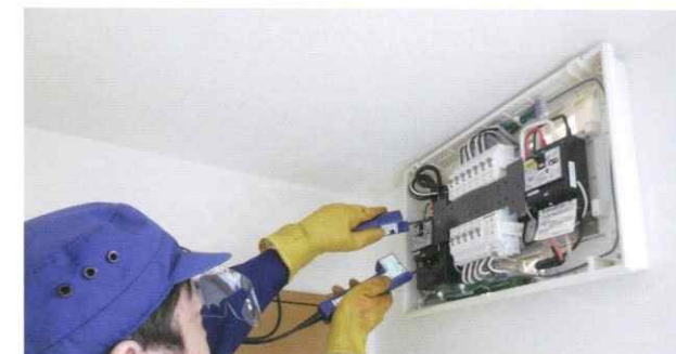
絶縁抵抗測定 ※停電して実施します。
