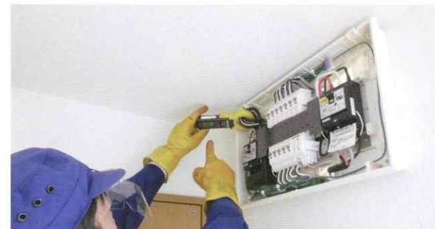
漏えい電流測定
