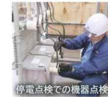
停電点検での機器点検
