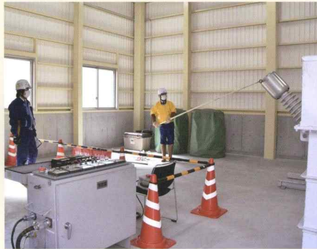
耐圧試験訓練棟(耐圧試験設備)
