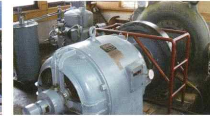
水路式小水力発電設備
