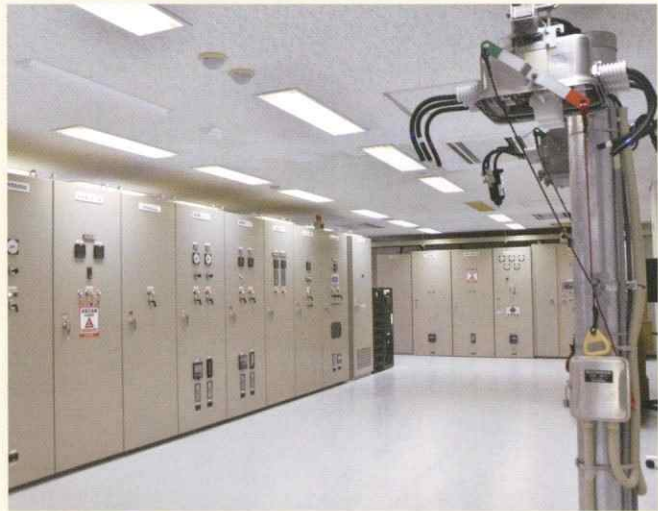
高压研修設備
