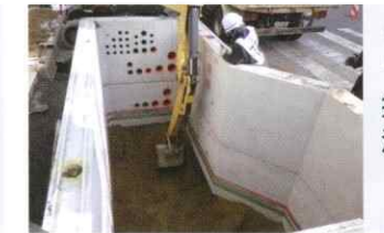
2 掘削(中堀)沈下
