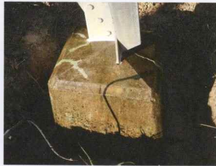
クラック補修
