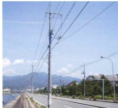
配電線・通信線用ポール
