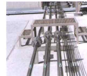
真空断熱配管 VACUUM HEAT-RESISTANT PIPING 極低温の液体酸素、液体窒素、液体アルゴンなどを供給するための配管。宇宙、電子、医療、食品産業などの先端産業に貢献しています。
