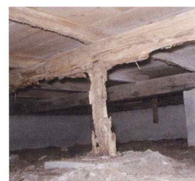
*シロアリ被害を受けた束柱
