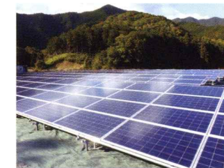
■太陽光発電所
