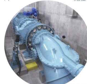
再生可能エネルギー (小水力発電)
