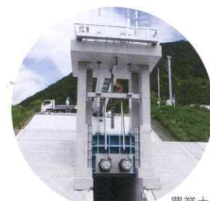
農業土木 (排水ポンプゲート)
