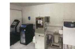
放流水自動監視測定室
