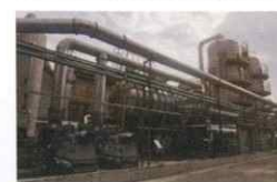
VOC処理設備
